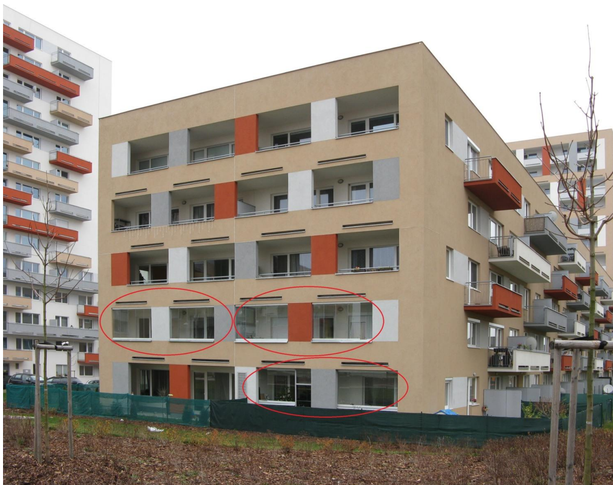
Zasklení lodžií, byt 222, byt 249, byt 250.
